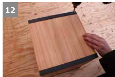
12 黒ビスで、アングルをコーナーに固定する。※ビス頭がアングルと平面になるよう、奥まで打ち込む。
