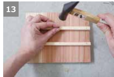
13 ⑫で引いた線に①の上面を合わせ、さらに背面合わせで小鋸19mmで3か所ずつ固定する。 ※2枚が対面となるよう向きに注意！
